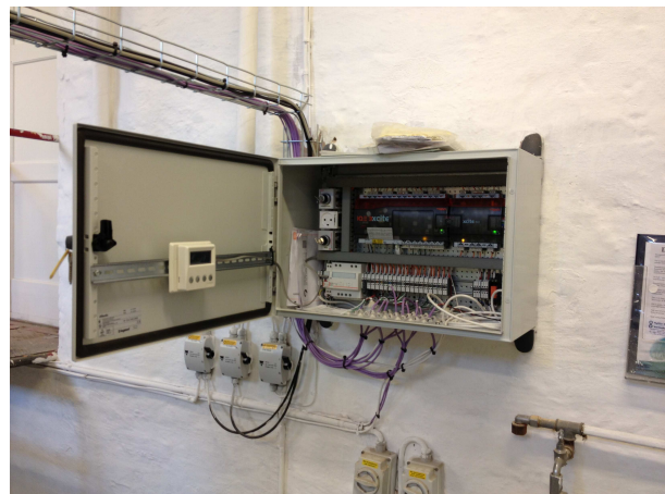
TREND CTS-anlæg monteret i skab
