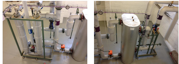
Varmecentral før renovering
